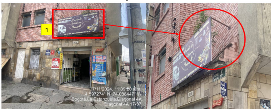
En la cual se evidencia un (1) elemento PEV volado de la fachada, identificado con el número 1.
